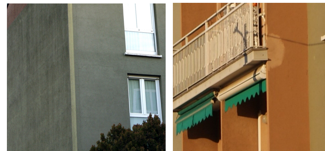
▲ Alcune porzioni delle facciate presentavano evidenti segni di ammaloramento.
